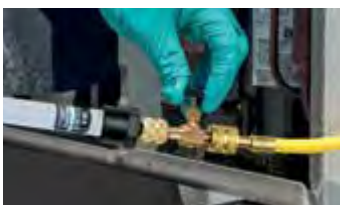
Cargue conductos con refrigerante
