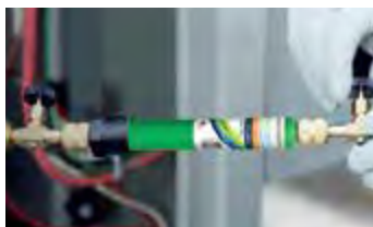
Cargue conductos con refrigerante
